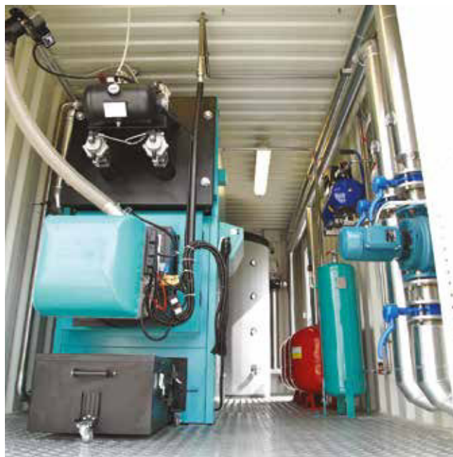
La caldaia EKO CKS P Unit da 230 kW installata. In fondo l'accumulo inerziale da 2.000 litri che completa l'impianto
