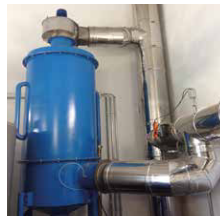
Il filtro a umido installato
