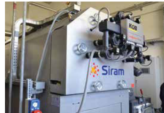
La caldaia Viessmann Pyrtec da 530 kW installata
