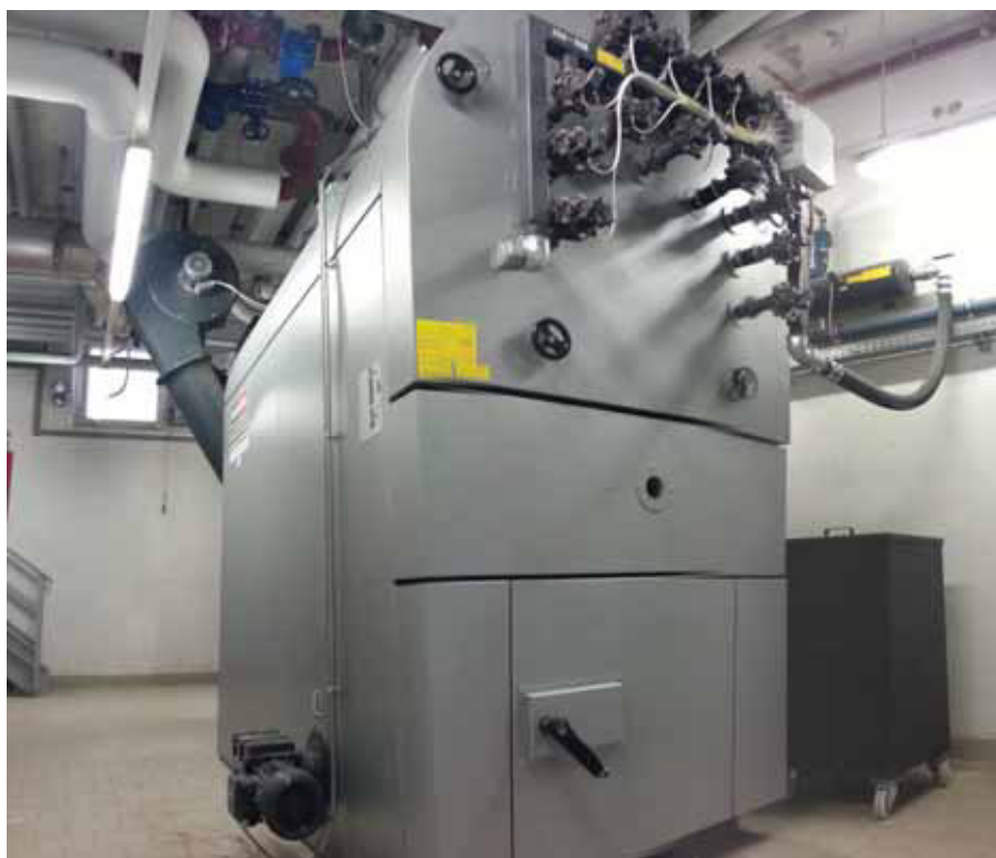
Foto 1 - La caldaia Pyrotec da 700 kW installata presso il centro acquatico di Canazei
