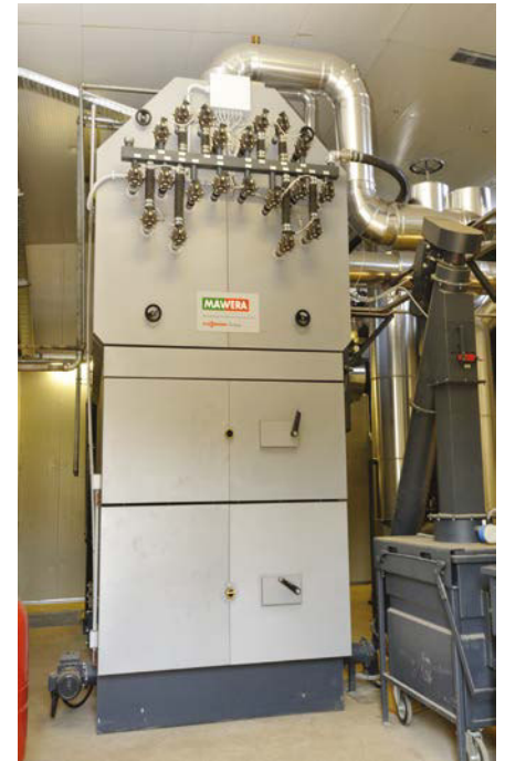
Caldaia Pyroflex FSB da 1.700 kW
