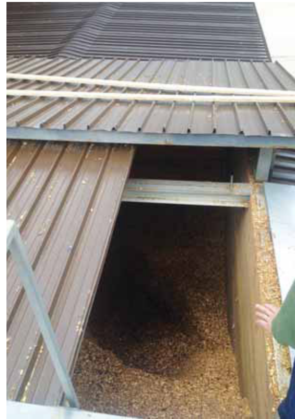
Il deposito del cippato costruito con la botola per il caricamento in alto posto al di sotto del livello stradale
