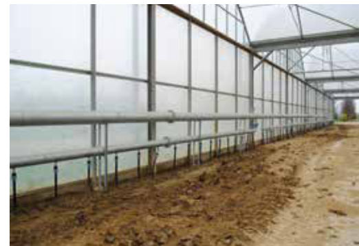
Sotto, impianto per il riscaldamento delle serre costituito da un articolato sistema di tubazioni interrate
