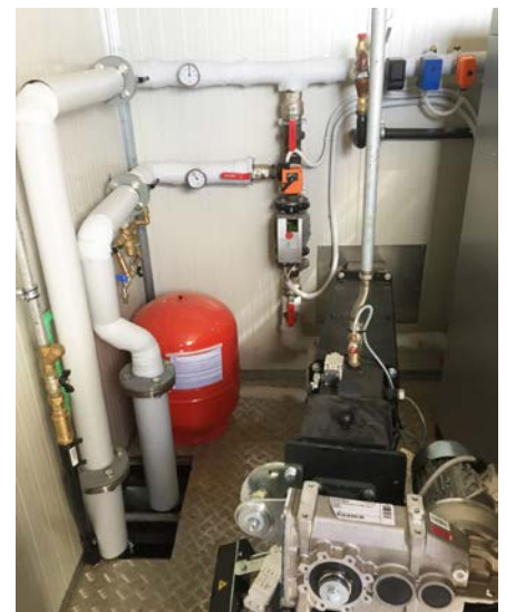
Partenza rete teleriscaldamento da container
