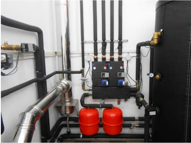
L'accumulo e l'impianto di distribuzione per riscaldamento e acqua calda sanitaria
