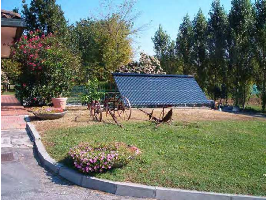
Il sistema solare Thermomax sottovuoto heat pipe da 6 mq. a ciclo evaporazione e condensazione installato nel giardino dell'abitazione di Raffaele maretto
