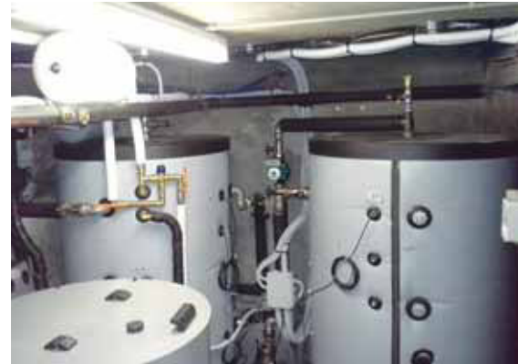
Dettaglio dei due puffer installati
