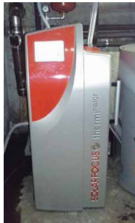
La caldaia Solarfocus Terminator II Touch da 30 kW installata, con a destra il serbatoio del pellet
