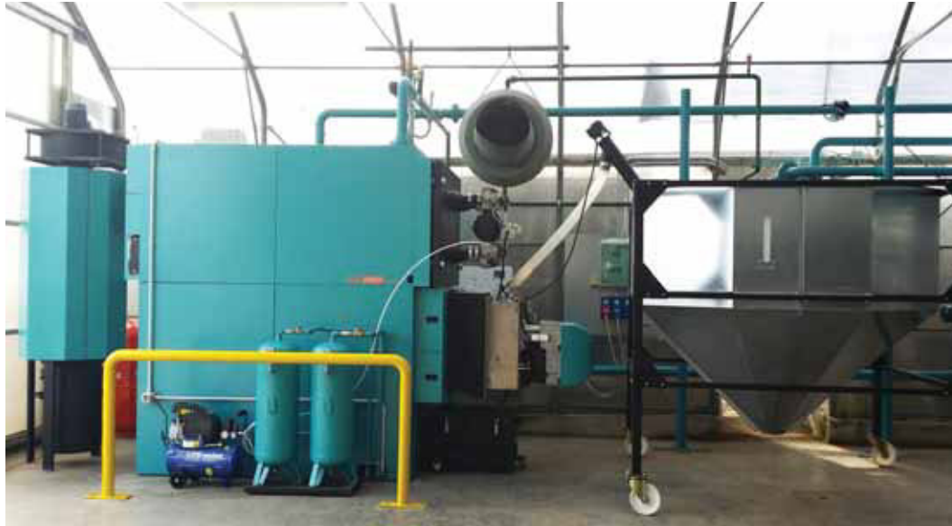
La caldaia Centrometal e il silo di stoccaggio della biomassa
