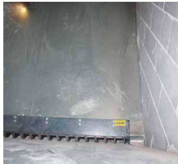
La coclea interna al deposito del pellet
